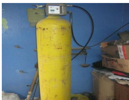
Figura N°2 Sistema Dosificador de Gas Cloro
