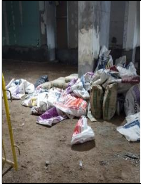
Figura 25 - Falta de orden y limpieza
