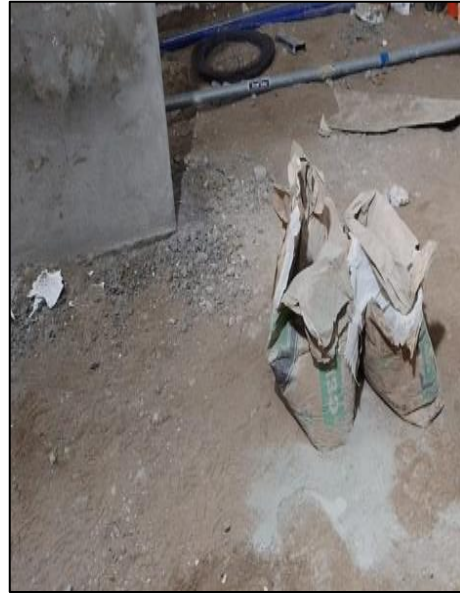
Figura 26 Falta de orden y limpieza
